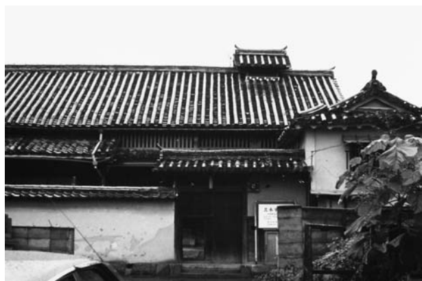
傷みの激しい主屋昭和 55 年
