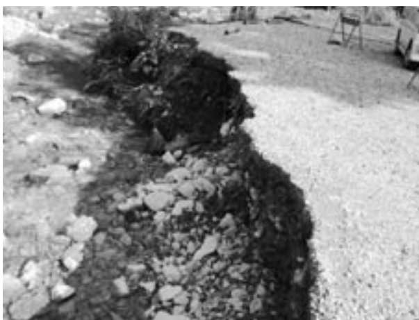
護岸がえぐられ、復旧を待つ駐車場
