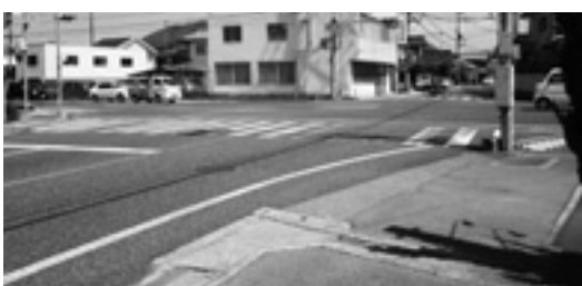
損傷の目立つ幹線道路
