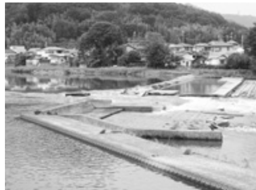
被災した新町大井堰
