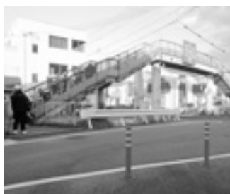
老朽化が進む辻川歩道橋
