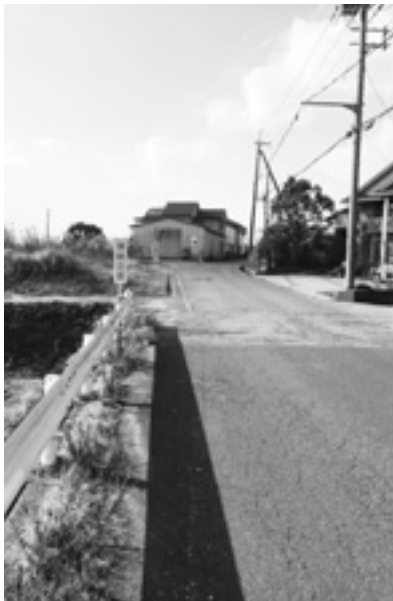
拡幅が望まれる県道中寺北条線
