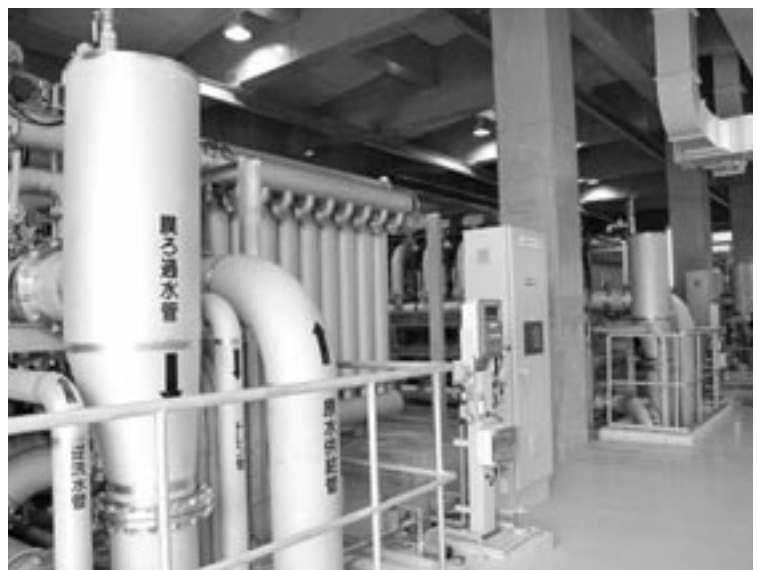
馬越浄水場の膜ろ過施設（今治市）
