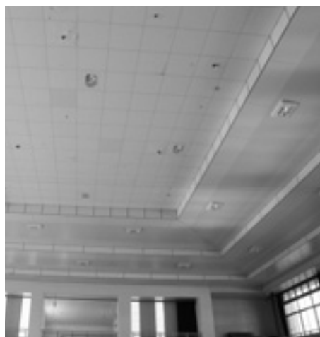
福岡小・高岡小も体育館がつり天井 (写真は福岡小)
