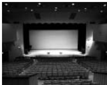
音響設備(大ホール)
