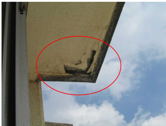
庇裏 爆裂事例
