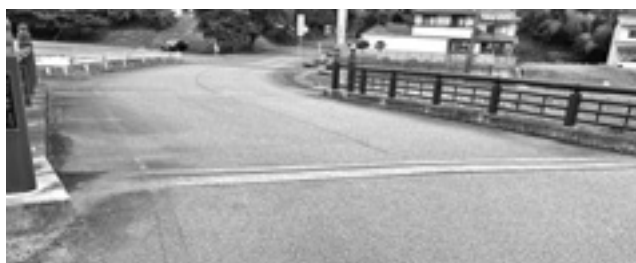
白線が消えている町道（岩尾神社前）
