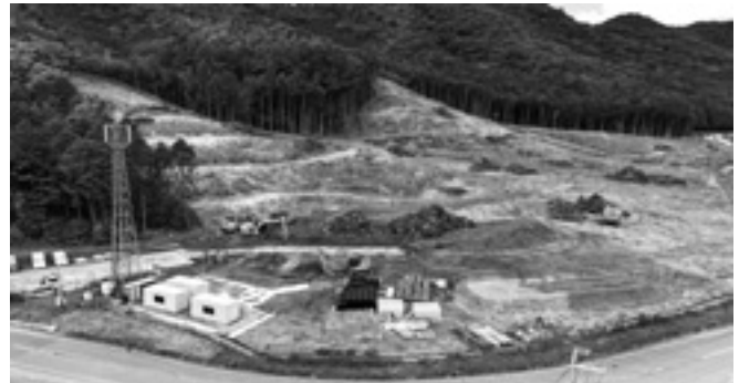
神崎郡ごみ処理施設建設用地造成工事のようす（6月撮影）
